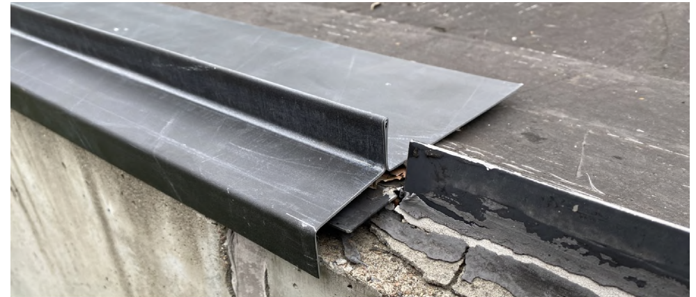
Tilbygning til Kildeskovshallen. reparation og forebyggelse, her skiftes til en ny og mere gennemtænkt tagkant
